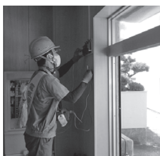
電気設備無料点検(海南・海草支部)
