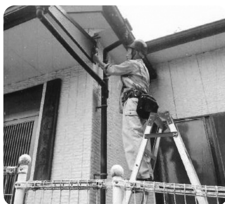
電気設備無料点検(海南・海草支部)
